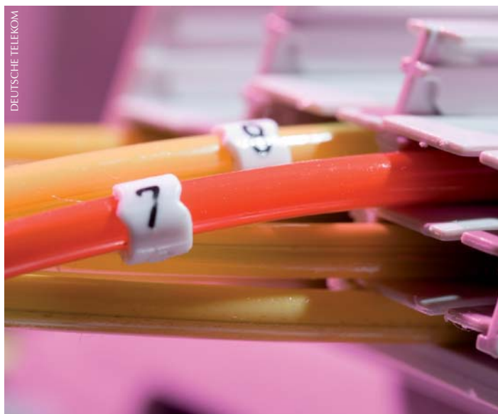
Glasfaserkabel der Deutschen Telekom
